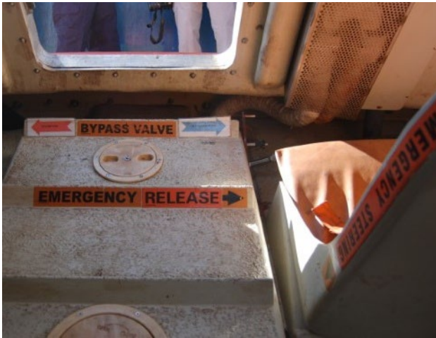
Figure 13. Le poste de largage, vu de l'intérieur de l'embarcation de sauvetage et faisant face à la porte, montrant des étiquettes en place au moment de l'événement (Source : BST)
